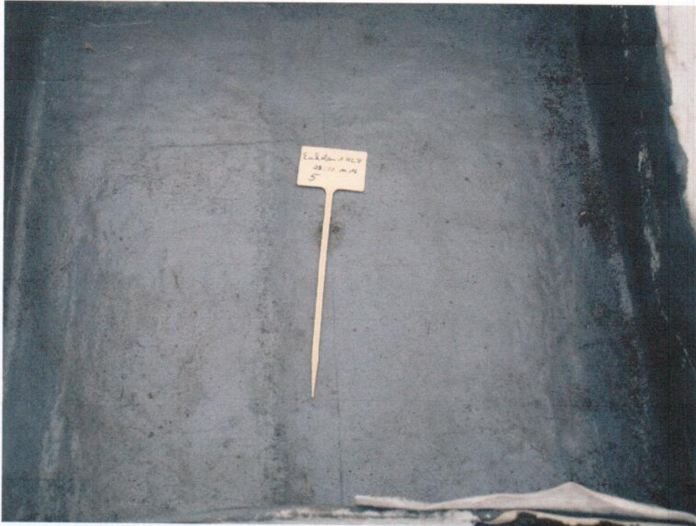
Abb. 1: Abdichtungsoberseite ohne Durchwurzlungen
