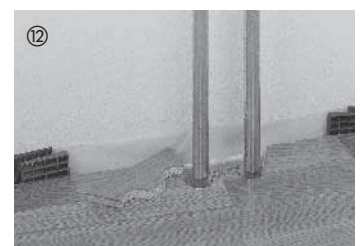
Für aus dem Boden herausragende Heizungsrohre werden in die Elemente Öffnungen (Größe abhängig vom jeweiligen Heizungsrohr und unter Berücksichtigung des erforderlichen Dehnungsabstands) gebohrt und gesägt.
