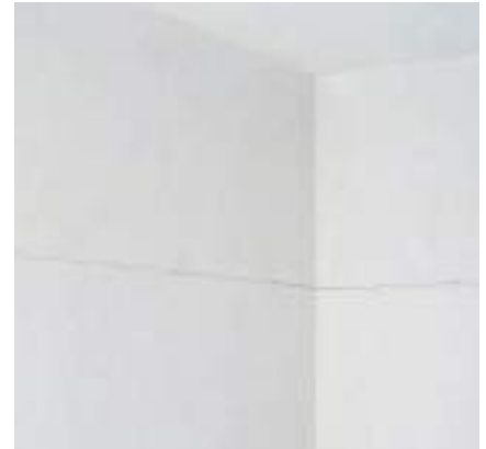
Bild 11 Rissbildung infolge Verkürzung der Decken in Wandlängsrichtung
