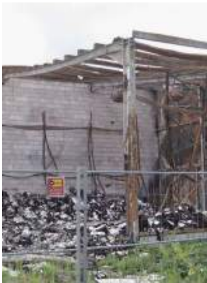
Bild 10 Durch Brand verformte Stahlkonstruktion vor unversehrter Kalksandsteinwand
