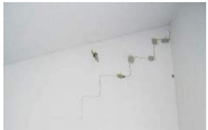
Bild 13 Rissbildung durch Verkürzung eines Stahlbetongurts
