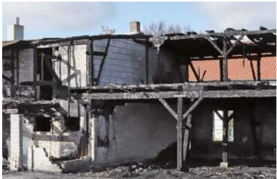
Bild 11 Durch einen Brand verkohlte Holzkonstruktion vor einer unversehrten Kalksandsteinwand; wegen ungetrennten Dachanschlüssen wurde das Feuer weitergeleitet.
